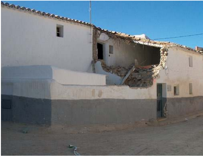
Daños en una casa de Zarcilla de Ramos por el terremoto de Bullas en 2005 (Mw=5.0)
